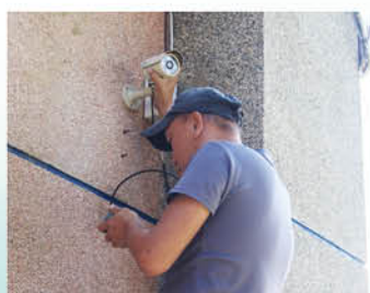
▲ 1061102 校園監視設備更新
